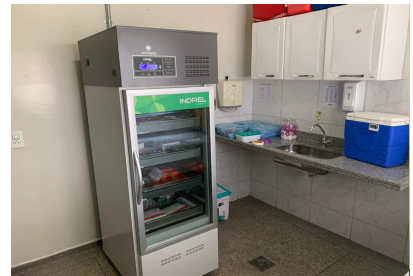
Câmara de Refrigeração de vacinas
